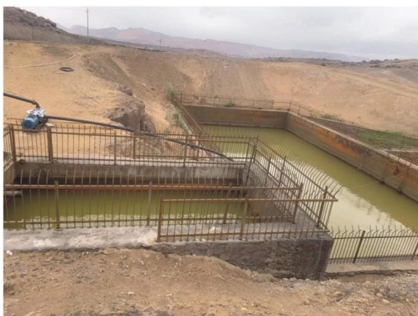
污水复用水沉淀池
