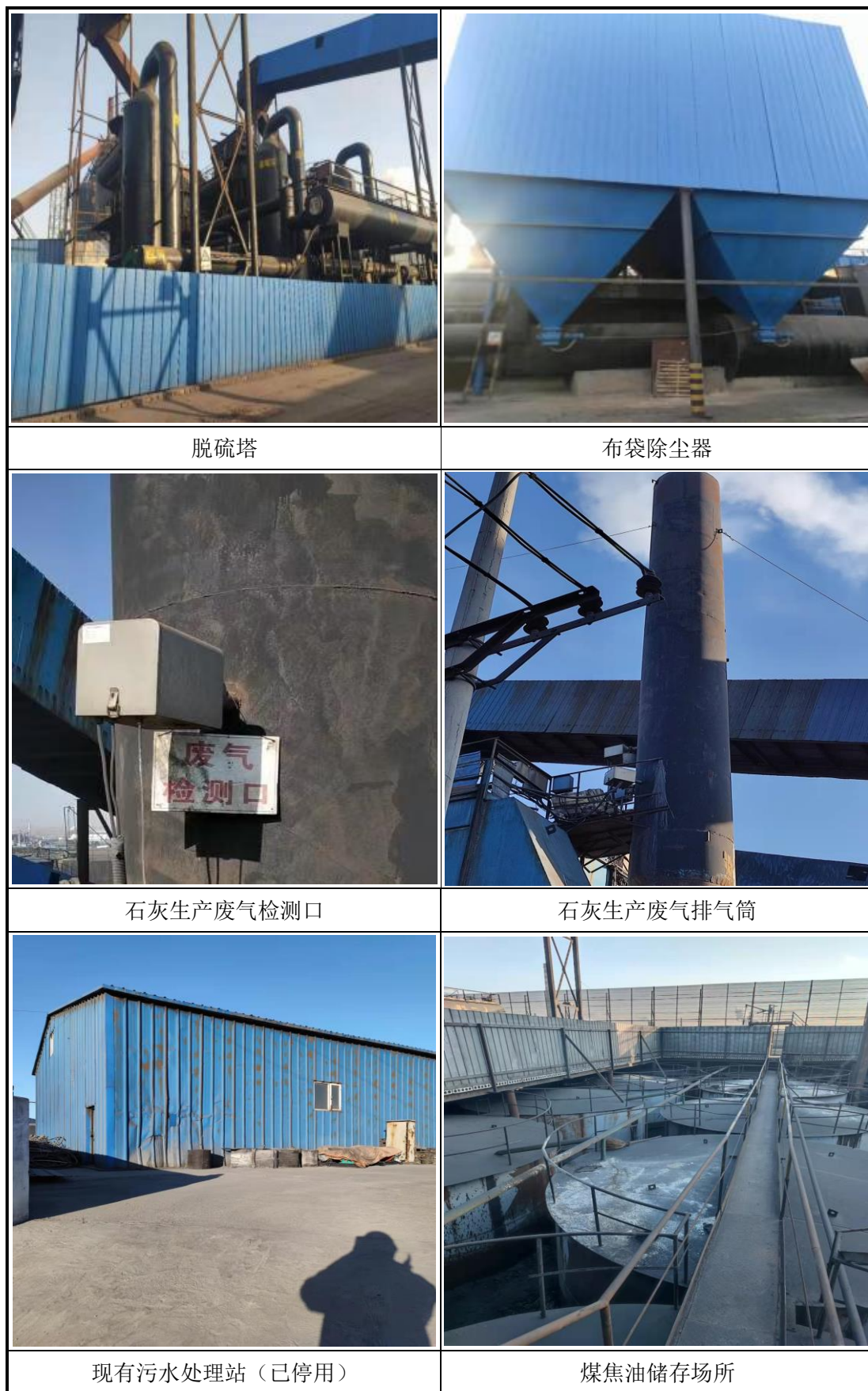
图 3.3-1 现有工程环保设施照片
